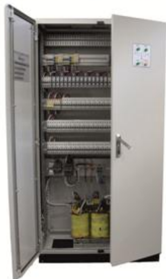
Разделительный трансформатор ТРТ-20000М
